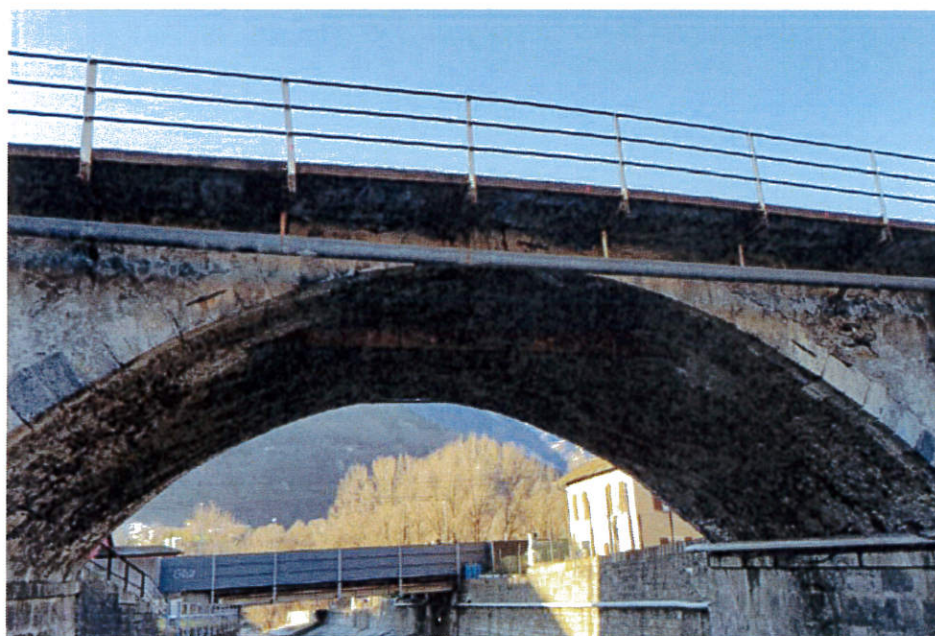
Ponte visto da Est Aggiunta del marciapiede in cemento armato, infrastrutture tecniche
